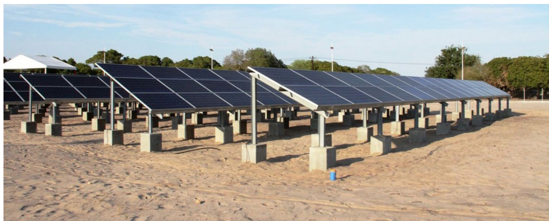
Electrificação do Posto de Administrativo de Changanine, Gaza
