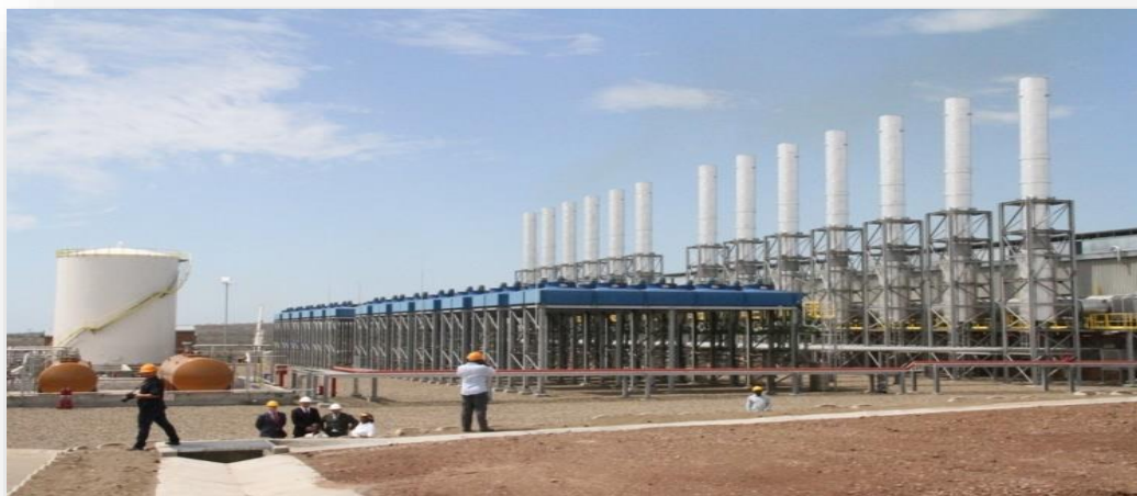
Central Térmica da Gigawatt
